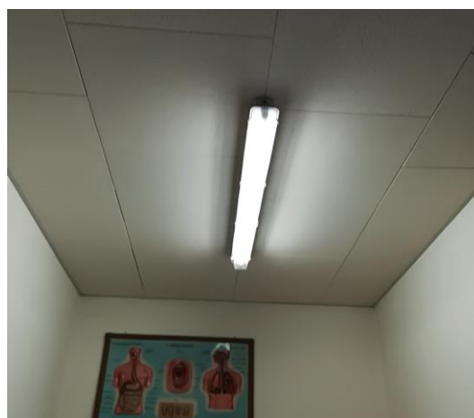
Figura 4.12 - Particolare dei corpi illuminanti ubicati nei locali dell'edificio
