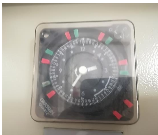
Figura 4.8 – Orologio generale a servizio dell'impianto termico
