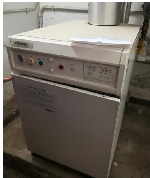
Figura 8.9 - Particolare del generatore di calore attuale
